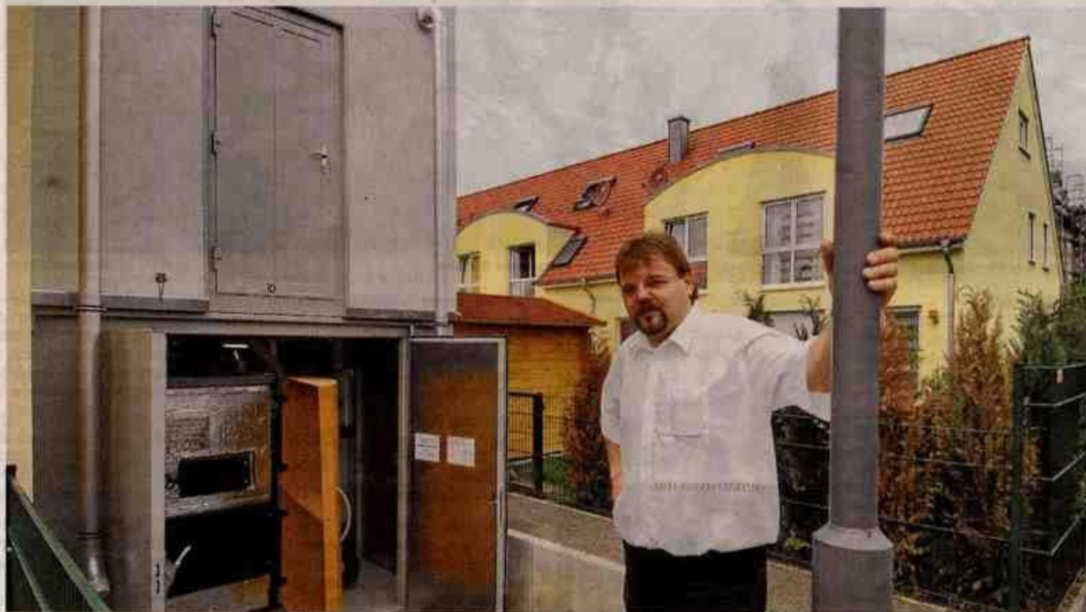
Alois Waldner öffnet für die RP die Anlage, die demnächst noch gestrichen wird. Die angelieferten Holzpellets werden über Einfüllstutzen in den oberen Lagerraum eingefüllt und von dort bei Bedarf über Förderschnecken in den Heizkessel (orangefarbene Tür) transportiert.
